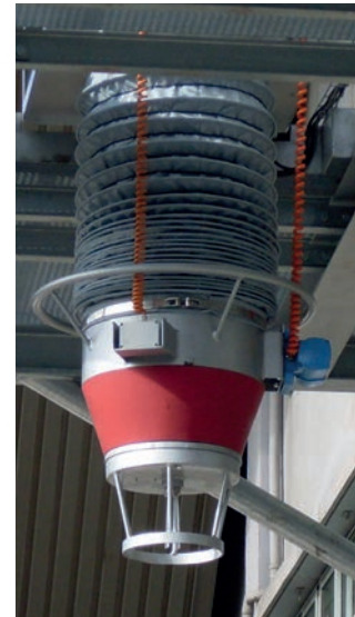
Limpeza mecánica y filtro de carga
